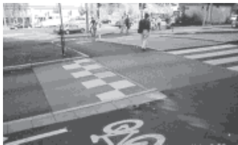
写真 6, 7: 歩道と同じ高さのハンプはあとから道路の上に盛り上げて作った応急措置的なつくりであるが、車は必ずとまらねばならない勾配になっている。
